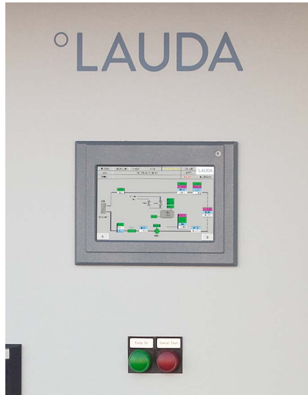
Panneau de commande du système de refroidissement industriel de process
