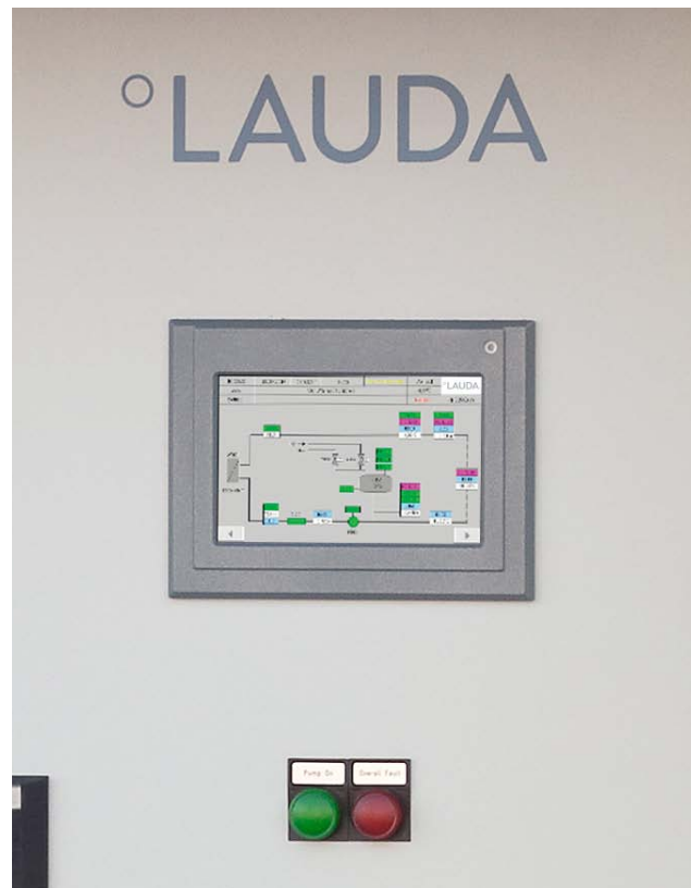
Bedienpanel der Prozesskühlanlage
