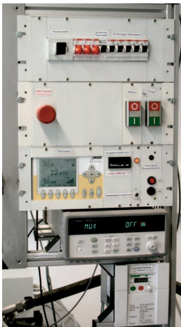
Abb. 4: Einbindung der Lauda Command Konsole in die Anlagensteuerung
