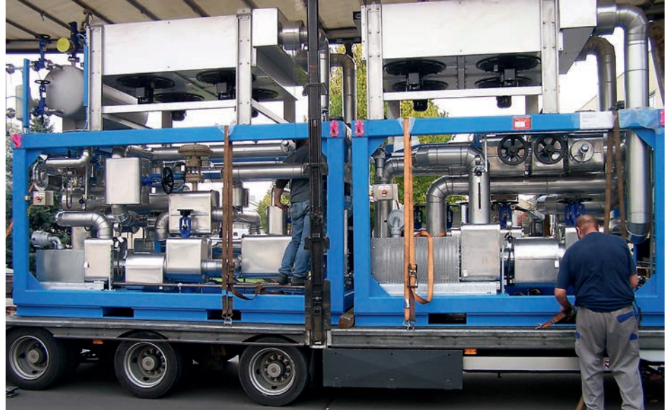
Sekundärkreisanlage in Atex-Ausführung mit aufgebautem Luftkühler
